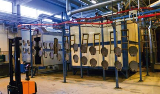
Pulverimaalauslinja lyhentää kappaleiden pinnoitukseen tarvittavia läpimenoaikoja.
